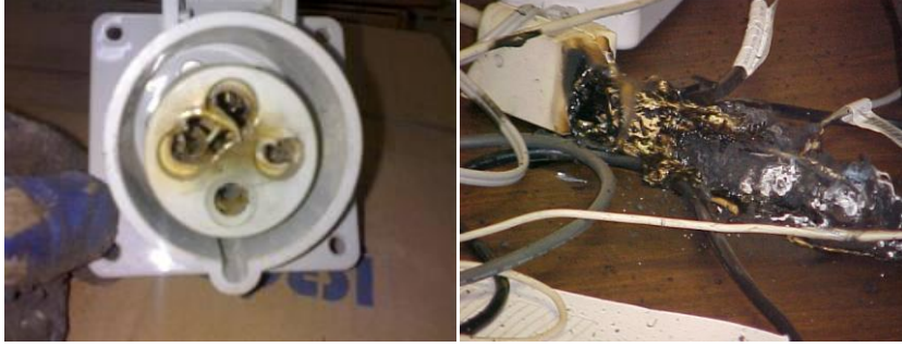
Resim 2.2: Yanmış priz ve kablo
