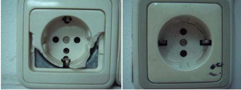
Resim 2.1: Kırık ve çatlak prizler
